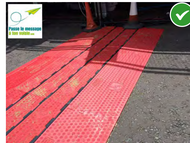
Exemple d'un passe-câble respectant les critères d'accessibilité
