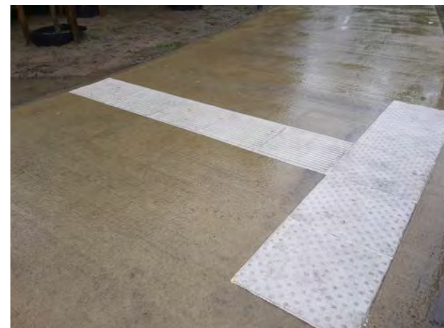
Revêtement podotactile préformé thermocollé
