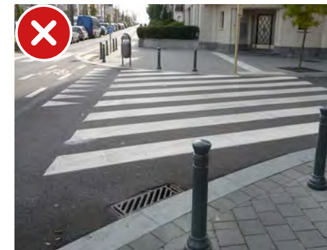
Avaloir placé dans la traversée piétonne
