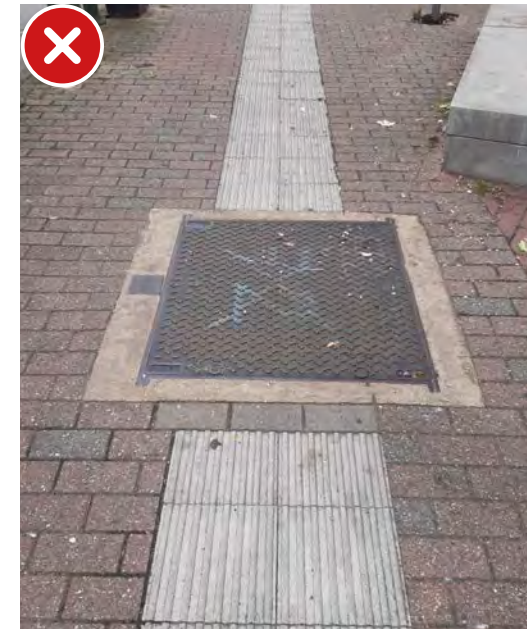
Le guidage podotactile ne peut être interrompu
