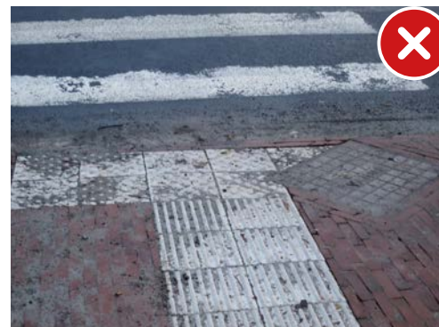
De inspectieput onderbreekt het gevaarsignaal dat door de noppentegels wordt gecreëerd!
