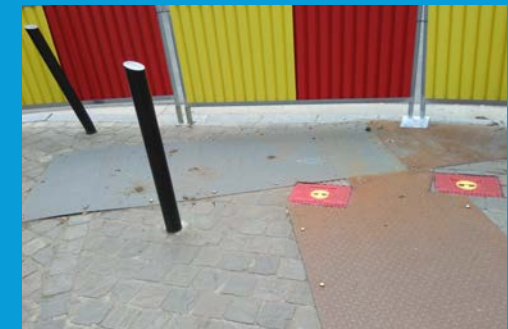
Tijdelijk door middel van metalen platen tijdens een werk geneutraliseerde podotactiele elementen
